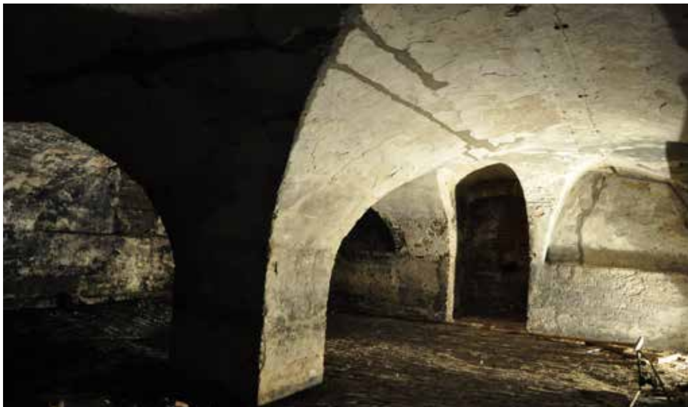
Bouwhistorisch onderzoek, Oude Boteringestraat 63, uit de 17 e eeuw daterende kruisgewelven in de kelder.
