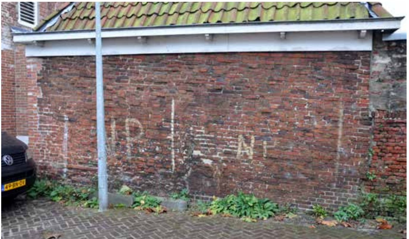
Herkennen en beleven, Sint Anthonygasthuis met scheef gezakt 17 e -eeuws muurwerk, omdat het is gebouwd op de gedempte gracht van de 16 e -eeuwse dwangburcht van Alva.
